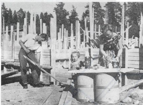
Tyypillinen perhekuva Nuutisen perheestä tällä hetkellä. Rouva Irja Nuutinen on "pannut pöydän korkeaksi", tosin vain parin vaneripytyyn päälle, mutta missäpä kahvi maistuisi paremmalta kuin omaa kotia rakennettaessa. Tytär on mukana touhussa sen kuin ehti.
